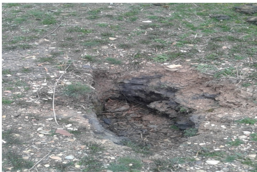
Фото 3.1.17 - Локальное разрушение защитного слоя на хвостохранилище «Дальний».
