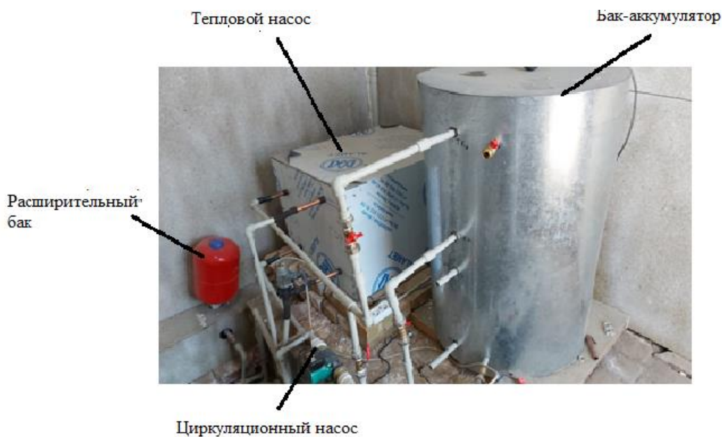
Рисунок 5 – Экспериментальный образец и общий вид двухконтурной гелиоустановки
