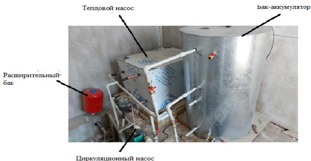
Рисунок 5 – Экспериментальный образец и общий вид двухконтурной гелиоустановки
