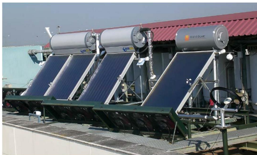
Рисунок 1.7 - Испытательная лаборатория двухконтурной гелиосистемы
