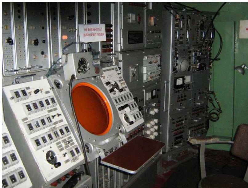
Рисунок 2.8 – Внешний вид стоек с аппаратурой станции
