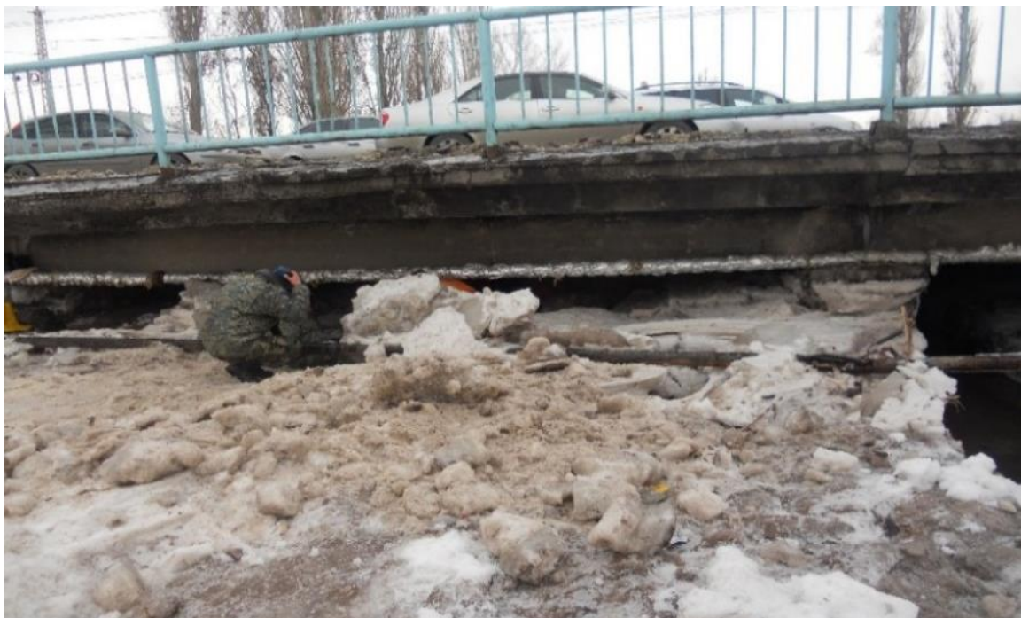
Рисунок 2.1.2 - Вид на зазор за мостом автомагистрали, на пересечении река Ала-Арча и ул. Льва Толстого, зимой после 28 января 2018 года. Снимок автора снят с северной стороны моста. Вода с крайнего правого пролета моста пробила себе туннель и затор был прекрещен
