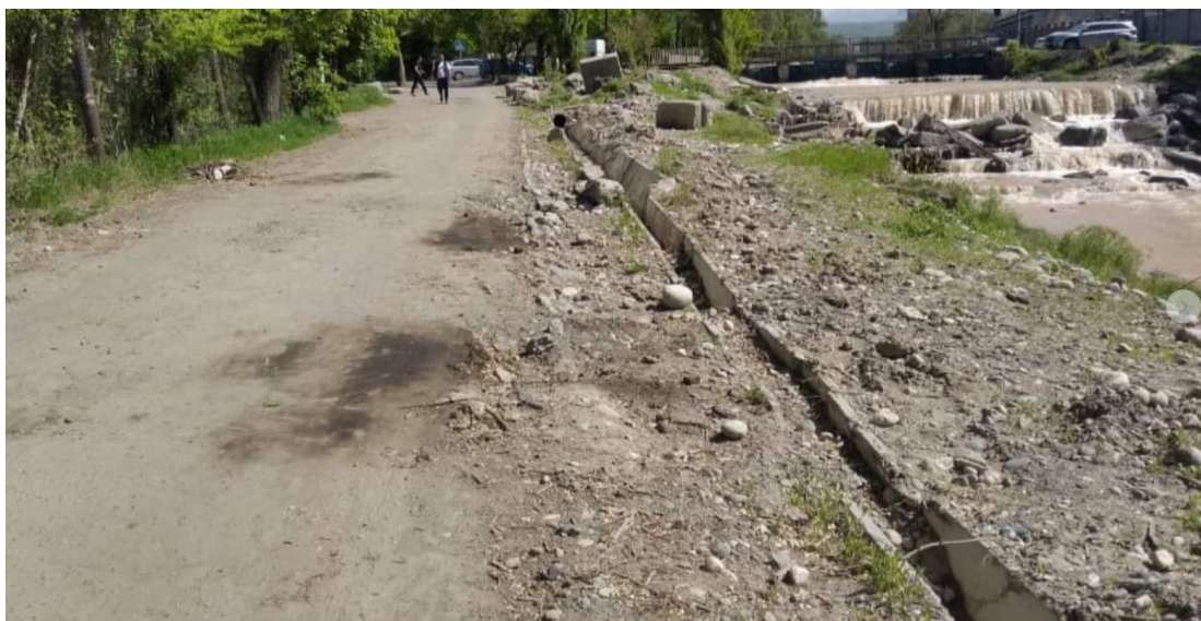
Рисунок 4. 2 .1- Состояние участка берега, после ликвидации затоов льда на русле реки Ала-Арча. Вблизи водораспределительного сооружения были разрушены арычные системы, принося ущербы
