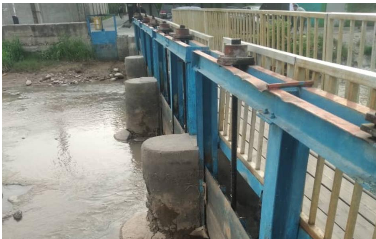
Рисунок 4.3.1 - Вид весной, по направлению съёмки, с Востока на Запада и под острым углом зрения на переднюю стенку листовых заслонок
