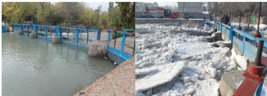
Рисунок 1.1.1 - Подпор летом Рисунок 1.1.2 - Затопление зимой Водораспределительное сооружение на реке Ала-Арча (ул. Скрябина)
