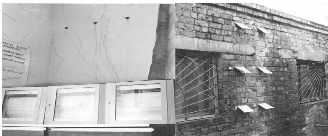
Рисунок 1 - Общий вид и местоположение измерительных приборов на внутренней и наружной поверхностях ограждения кирпичного здания лабораторного корпуса
