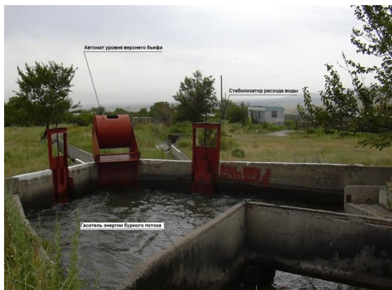
Рисунок 2.5 - Водораспределительный узел на канале-быстротоке «Жаламыш» в Сокулукском районе Чуйской области Кыргызской Республики
