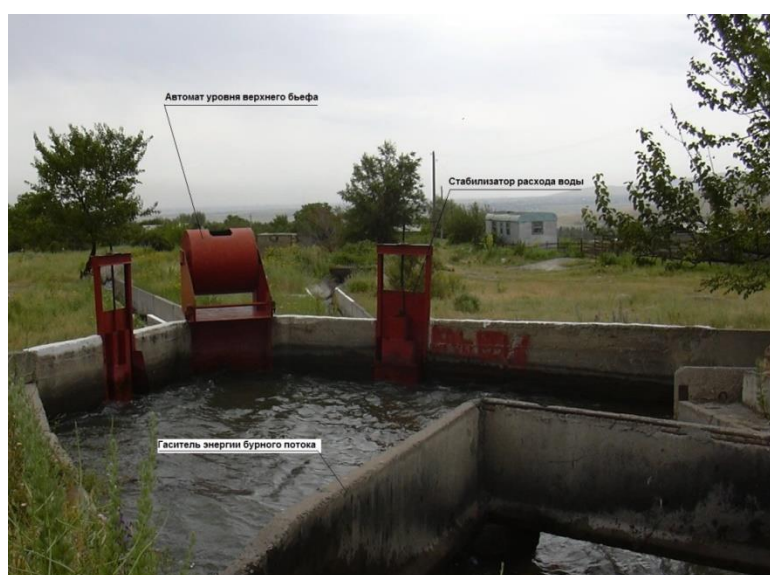
Рисунок 2.5 - Водораспределительный узел на канале-быстротоке «Жаламыш» в Сокулукском районе Чуйской области Кыргызской Республики
