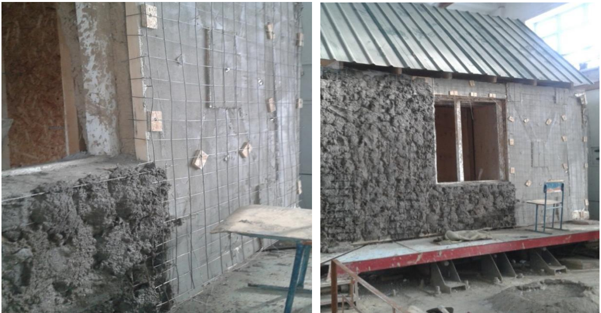
Рисунок 6.16 - Установка вертикальных сеток снаружи с оставлением зазора 15-20 мм и штукатурка цементно-песчаным раствором.
