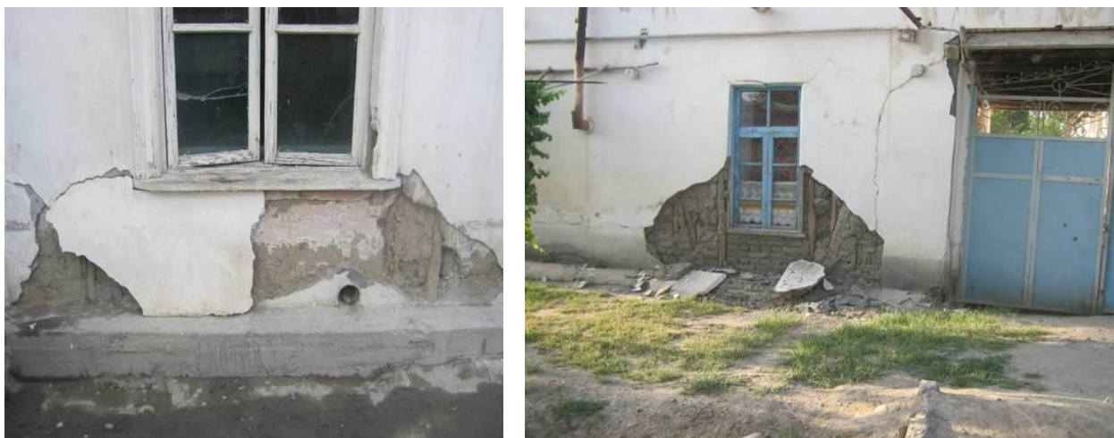
Рисунок 2.16 - Повреждения стен сынчевых зданий.
