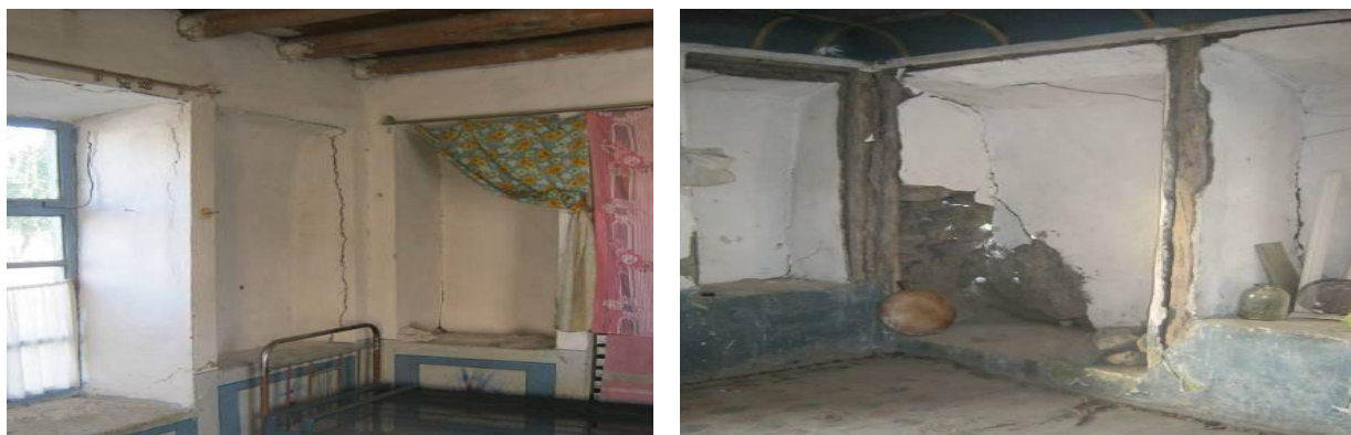
Рисунок 2.17 - Повреждения зданий с двойным сынчевым каркасом.
