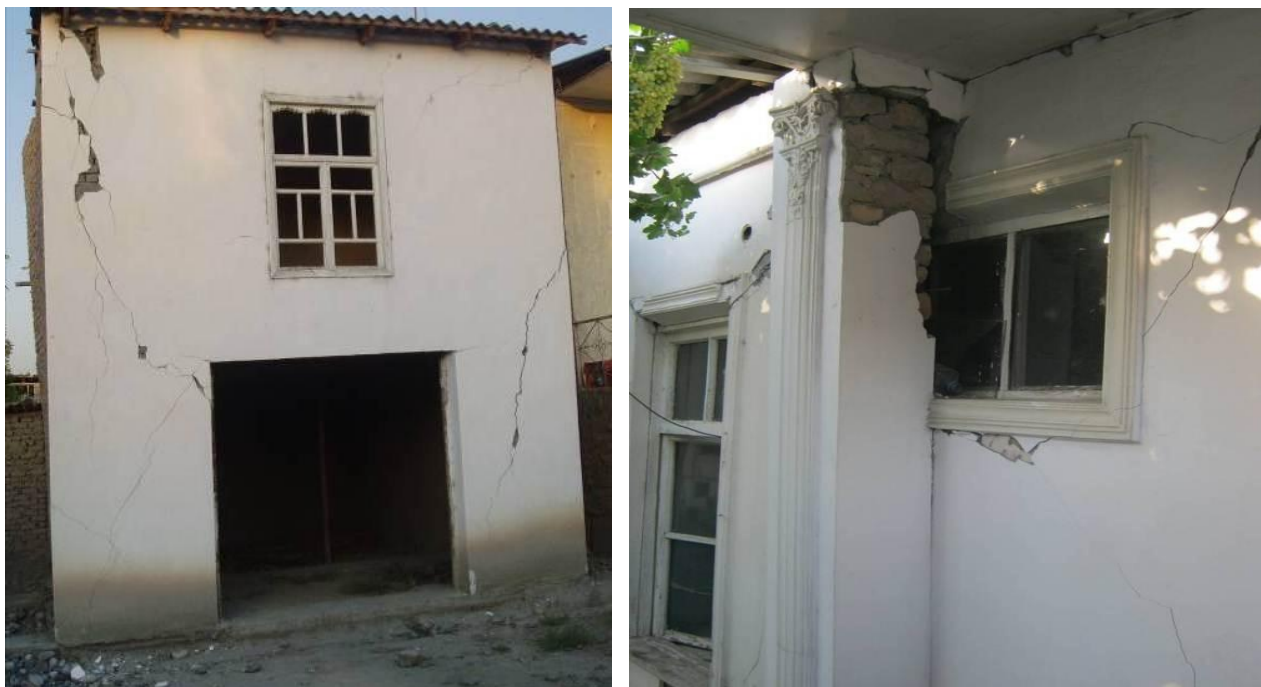
Рисунок 2.5 - Повреждения здания со стенами из сырцового кирпича при землетрясении 20.07.2011 г.
