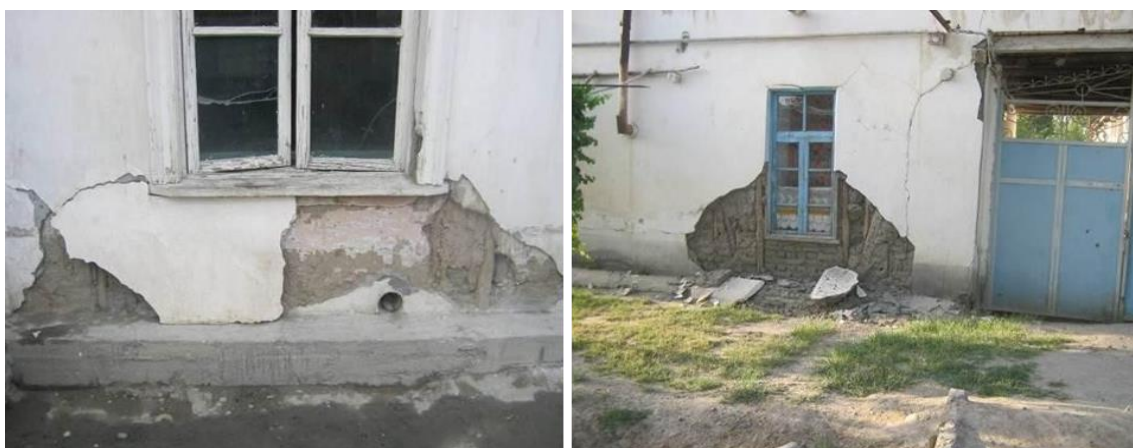
Рисунок 1.5 - Повреждения стен сынчевых домов при землетрясении 20.07.2011 г, в Баткенской области, с. Кан.
