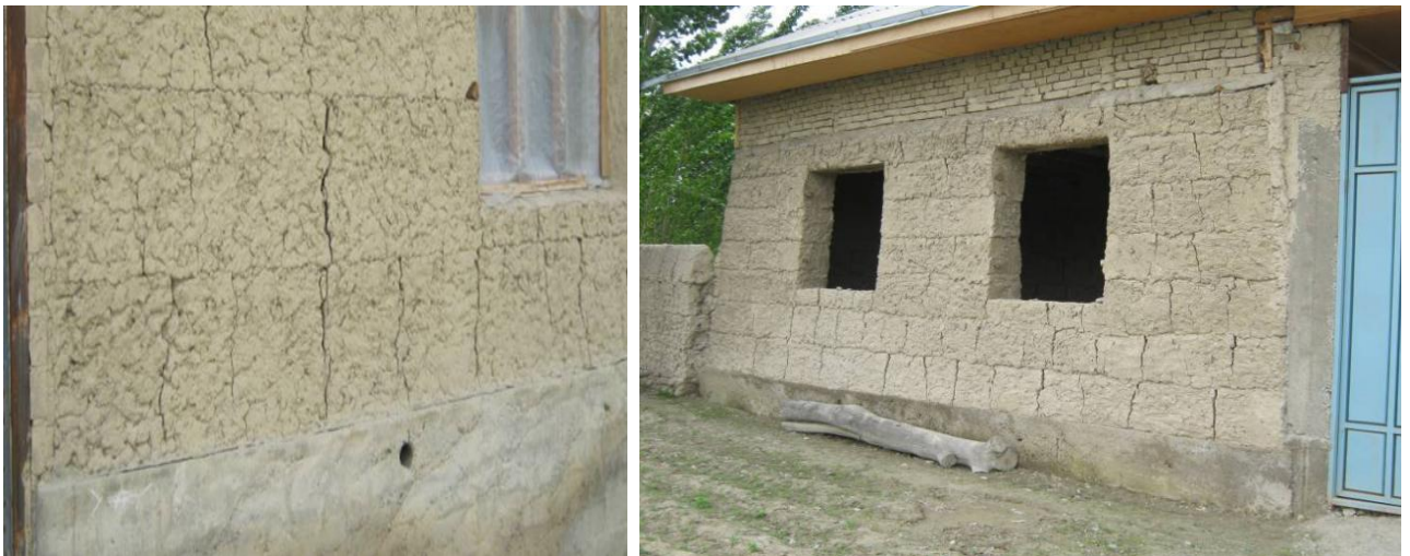
Рисунок 2.9 - Здание со стенами из пахсы гидроизоляция выполнена из рубероида
