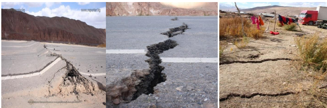
Рисунок 2.4 - Трещины на асфальтовой дороге и на поверхности, после землетрясения.
