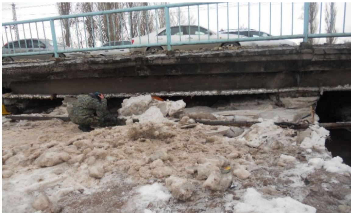
Рисунок 2.1.2 - Вид на зажор за мостом автомагистрали, на пересечении река Ала-Арча и ул. Льва Толстого, зимой после 28 января 2018 года. Снимок автора, снята со северной стороны моста. Вода с крайнего правого пролета моста пробила себе туннель и затор был прекрещен
