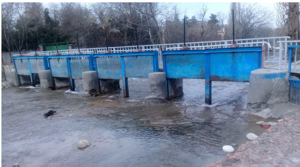
Рисунок 1,5-1 - водораспределительное и регулирующее гидротехническое сооружение (ВРиРГТС) – далее в текстах. Снимка от 4 апрель 2023 год, вид с востока на запад, по течению воды и находится близ «Института геомеханики и освоения недр» и «Институт машиноведение» НАН КР, также МП водным хозяйством, на ул. Скрябина.
