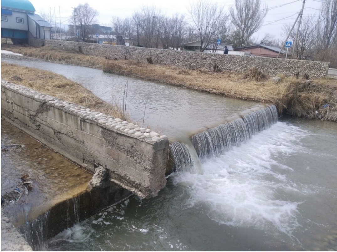
1.5 – 50- Вид на русла реки Ала-Арча, видом на ступеньки с водопадом
