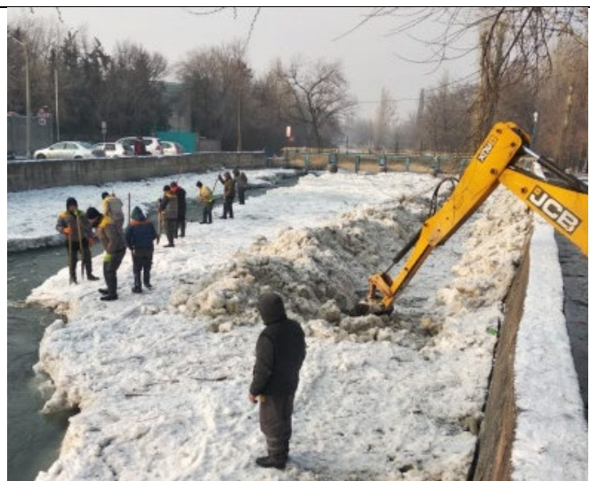
Рисунок 2.1.4 - Вид на отвода воды из-под зазорного покрова льда на участке до сооружения, снимка 13 января 2023 года
