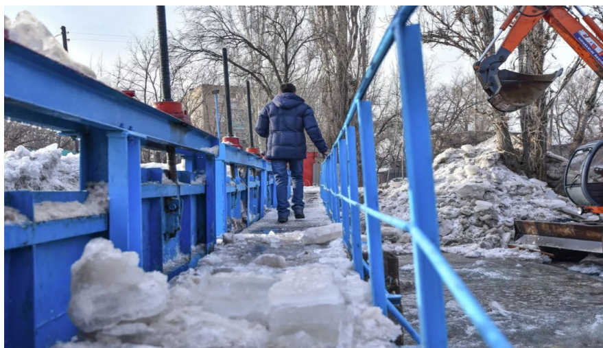
Рисунка 2.4.1 - Пешеходный мост с гидросооружением на реке Ала-Арча, тот, что и на рисунке 2.1.1, но уже очищенного от зажора
