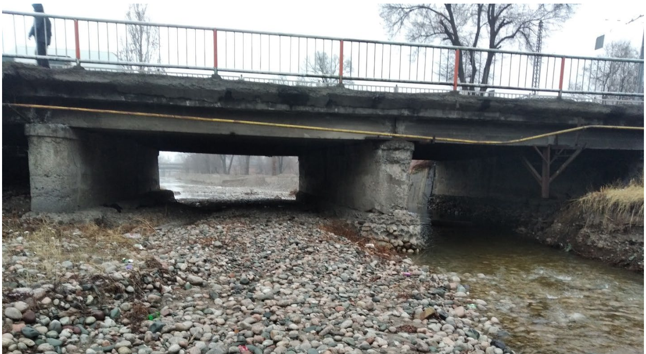
Рисунок 1.5-29 – Вид на средний и правой крайней проход моста, что на рисунке 1.5-27. Как видны вода протекают только через крайний проход
